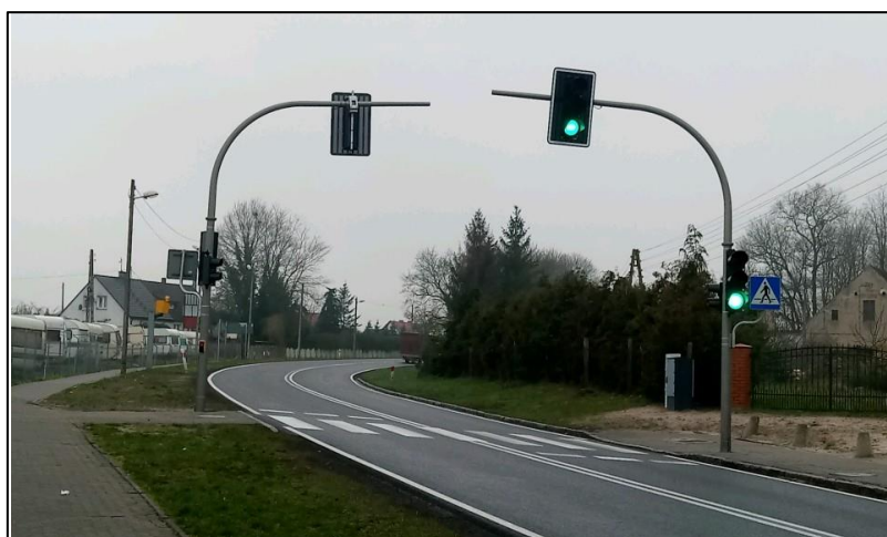
Sygnalizacja świetlna w Wapnicy
