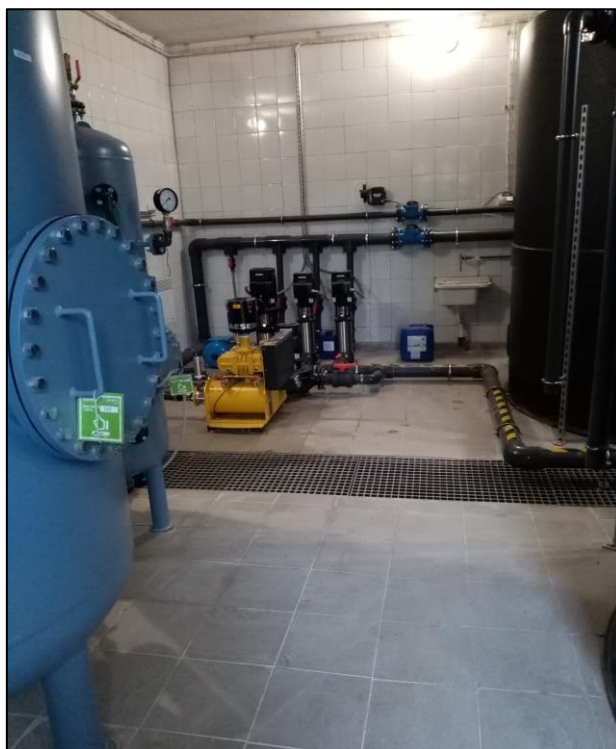
Urządzenia technologiczne w SUW w Wapnicy
